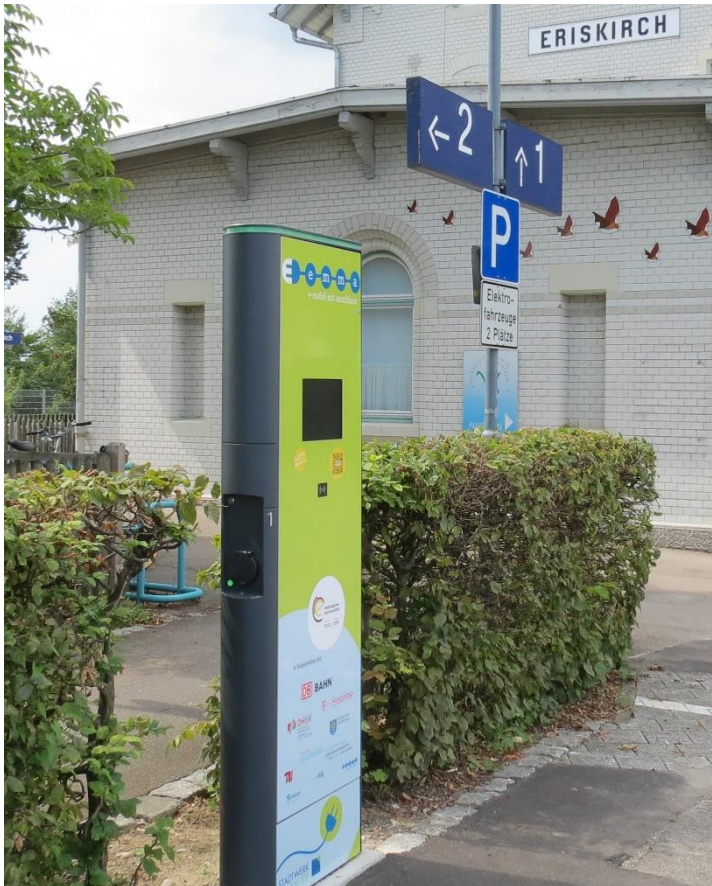
Abbildung 1 Beispiel einer installierten Veniox-Ladesäule am Bahnhof Eriskirch
